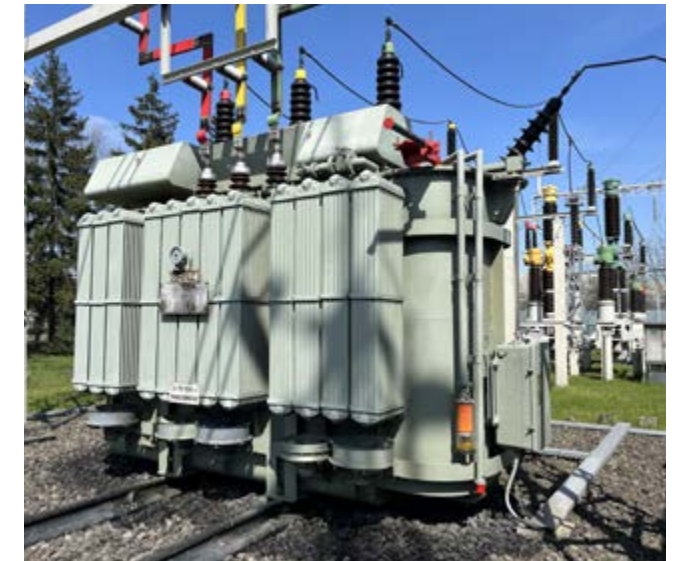
NAF/KÖF (nagyfeszültség/középfeszültség) transzformátor fokozatkapcsolóval Fotó: MVM Émász Áramhálózati Kft. és MVM Démász Áramhálózati Kft.
